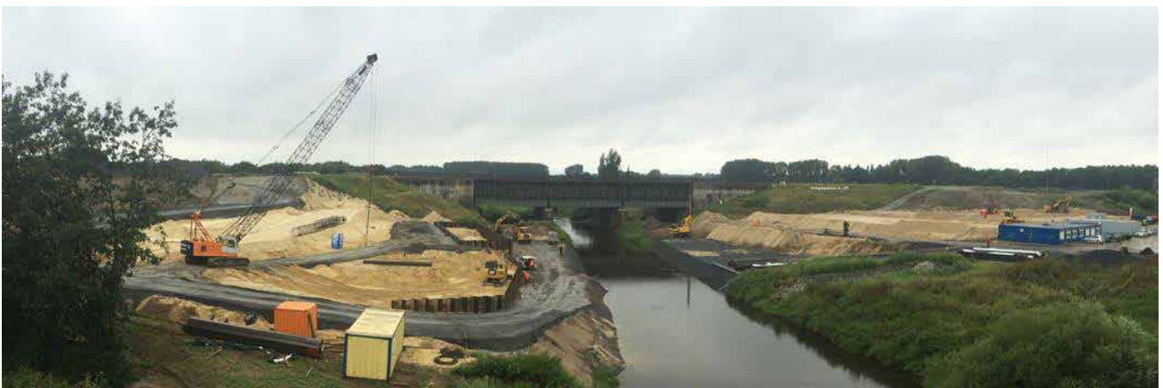
Bild 3: Blick auf die beiden späteren Brückenwiderlager; Widerlager Süd (links) mit bereits hergestellter Flügelspundwand
